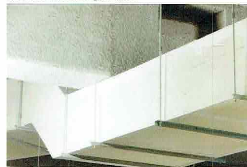
Conduit de désenfumage, 6 000 m 2
